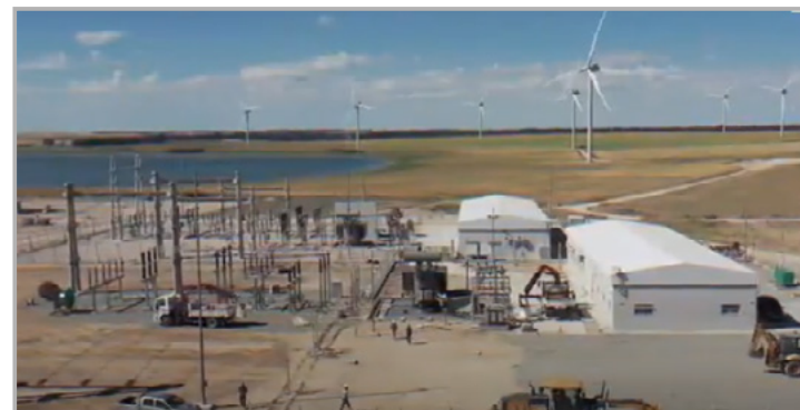
Parque Eólico Pampa Energía II
